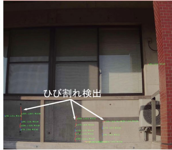
【A Iによる判別結果の一例 (4 Kカメラ画像を用いたひび割れ検出)】
